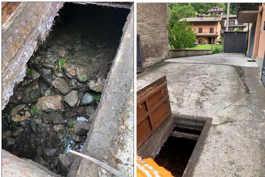
Presenza di sedimenti nel tratto intubato della Val Crepa a monte dell'attraversamento di via Locatelli
