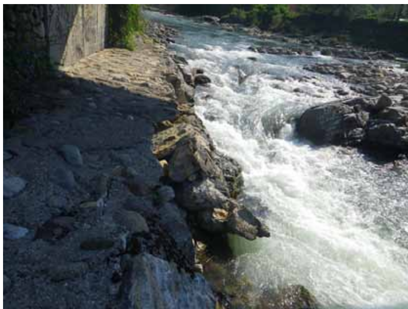
Scogliera danneggiata alla base della spalla in destra idrografica
