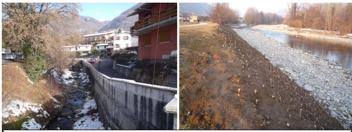
Difese spondali longitudinali lungo il torrente Valgua e il fiume Serio
