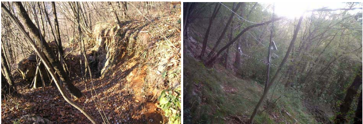
Frana di Provati: la fessura principale di stacco della frana e un estensimetro a filo
