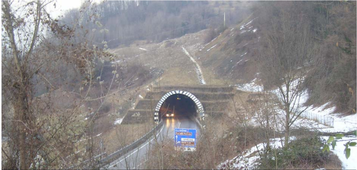
Zona franosa a valle di SS Trinità presso l'imbocco della galleria con acclività media ( 35^\circ < \beta < 45^\circ )
