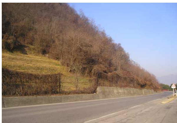
Barriere paramassi lungo la strada provinciale
