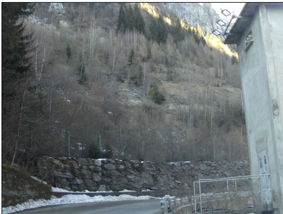
Foto 1: tratto di versante all'imbocco del territorio comunale di Carona e a monte della zona artigianale. A monte della muratura realizzata a contenimento dei terreni soggetti a smottamento e per la posa della barriera paramassi a protezione della sede stradale non sono presenti forme di scorrimento idrico ascrivibili al reticolo idrico minore che raggiungono il fondovalle e la zona artigianale.
