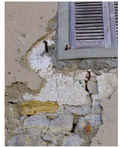
n. 1 (dettaglio intonaco originario)
