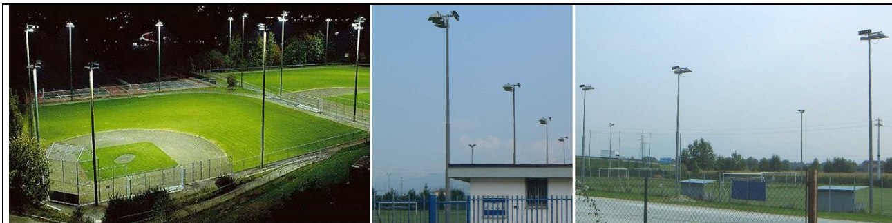
Figura 5.24 - Impianti sportivi illuminati in modo conforme alla L.R.17/00 con proiettori asimmetrici orientati orizzontalmente e che non disperdono luce verso l'alto.
