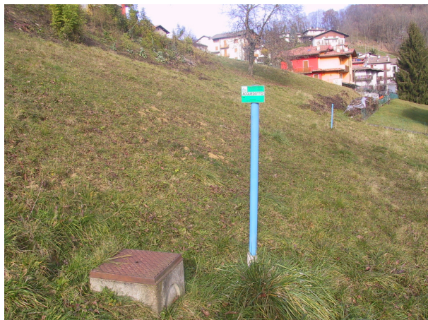
Foto 3: Paletto di segnalazione della rete acquedottistica in località Ascensione.
