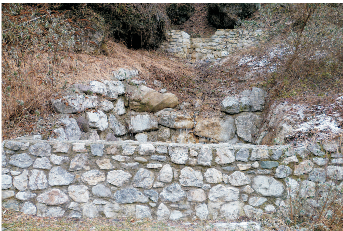
Foto n° 4: Briglia in sassi e vasca di decantazione sulla valle Buca a monte della pista ciclabile
