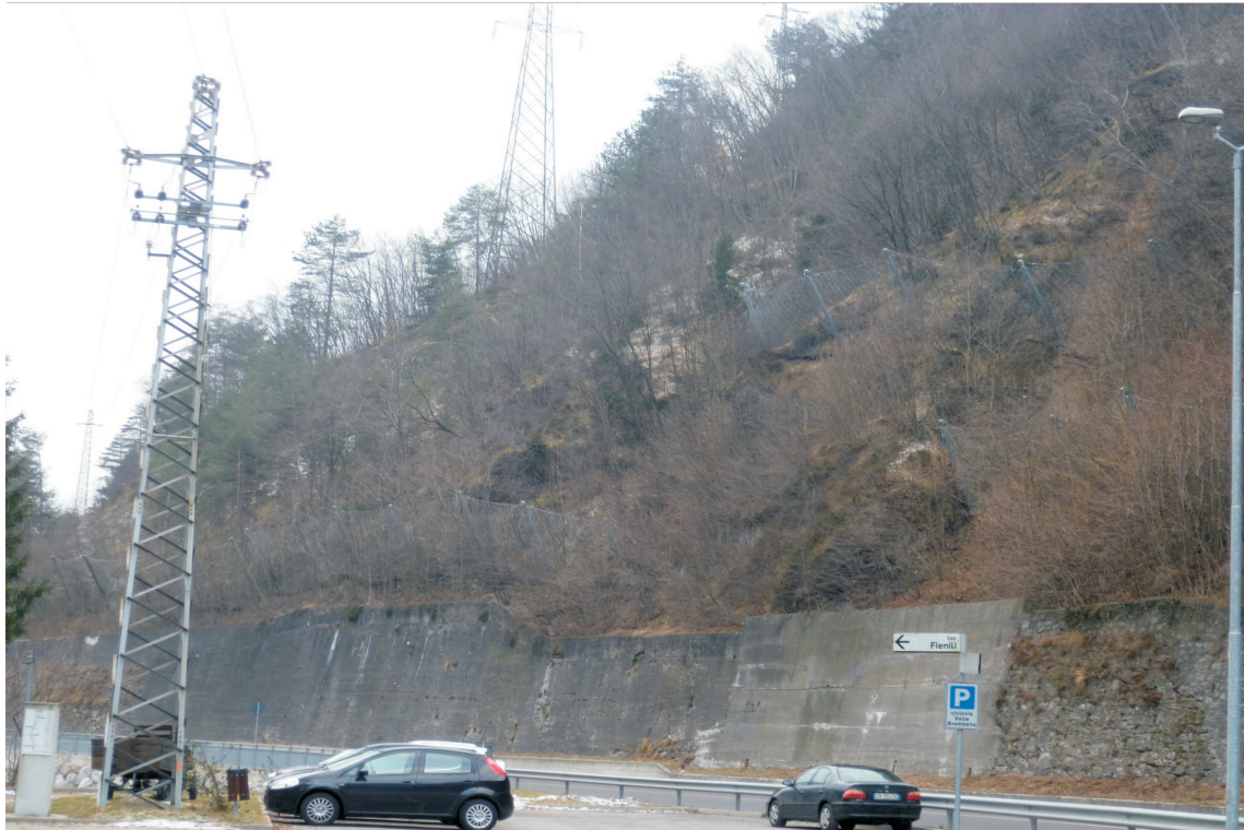
Foto n° 1: Barriere paramassi a monte della S.P. 471 sul rettilineo di Scalvino
