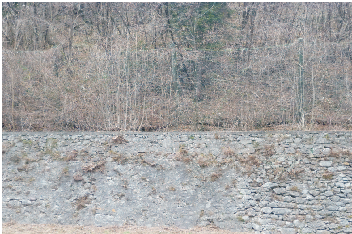
Foto n° 2: Barriere paramassi a monte della S.P. 471 sul rettilineo di Scalvino
