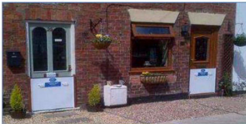
Paratoie manuali a protezione di porte di ingresso
