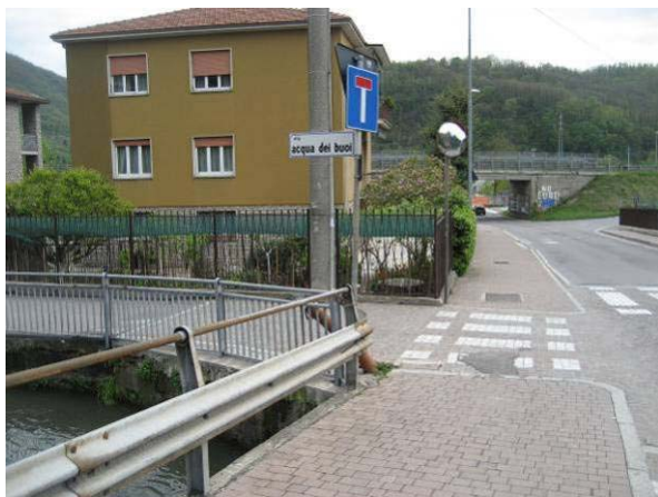
Gli attraversamenti sono ciclopedonali ma manca la segnaletica orizzontale e verticale del ciclabile
