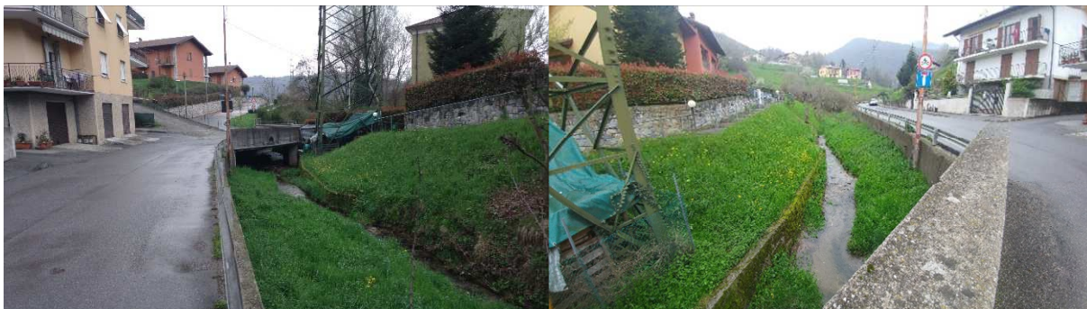
Foto 43: Tratto del T. Luio all'altezza del ponte a quota 320 m slm. Vista da monte a sx e vista da valle a dx. Possibili esondazioni sul lato sinistro (Nembro) in caso di sovralluvionamento o ostruzione del ponte.
