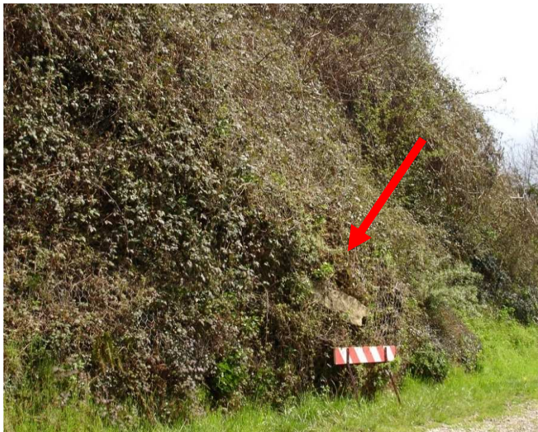
Foto 9: parcheggio di monte del Santuario dello Zuccarello: reti in aderenza in parte deformate e ricolme di materiale (vedi freccia rossa)
