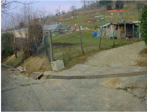
Foto 1: griglia per il collettamento delle acque provenienti dal versante a monte via Carere
