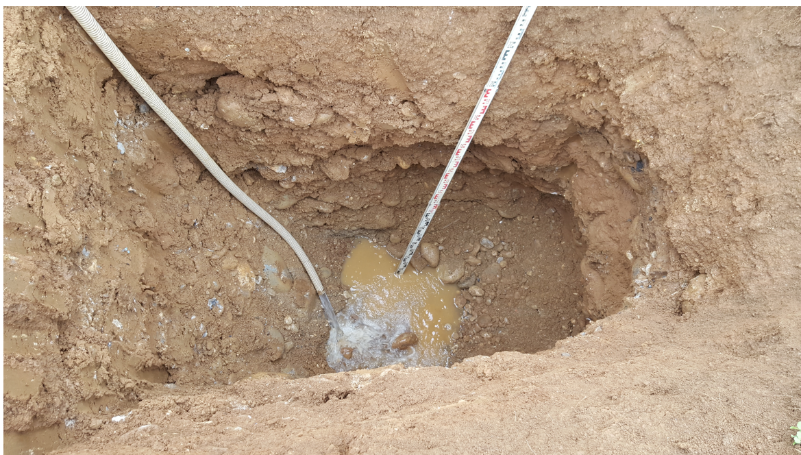
Foto n. 14: immissione dell'acqua necessaria alla conseguente prova di permeabilità a carico variabile, eseguita nel pozzetto A4
