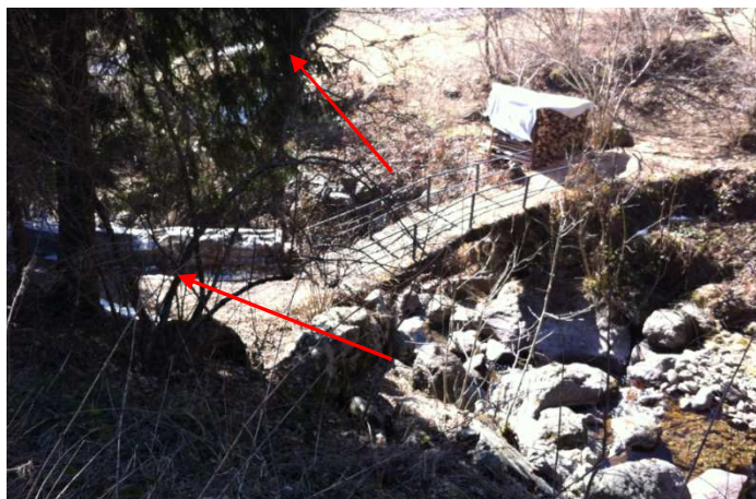
Foto 146. Punto di possibile tracimazione in sponda destra e sinistra idrografica all'altezza del ponte pedonale a monte della confluenza con il Canale del Roc
