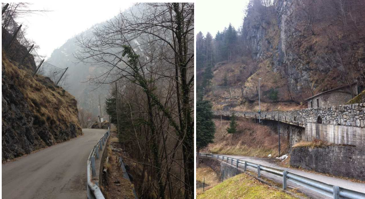
Foto 28: reti paramassi, reti in aderenza e chiodature degli ammassi rocciosi soggetti a crolli lungo la strada provinciale per Ornica
