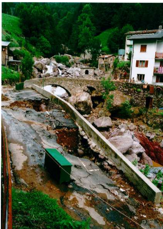
Foto 101. Sponda destra idrografica a valle del Ponte della Rasega a seguito dell'evento del luglio 1987 (per concessione di Studio Fotografico Passerini Raffaella di Piazza Brembana)
