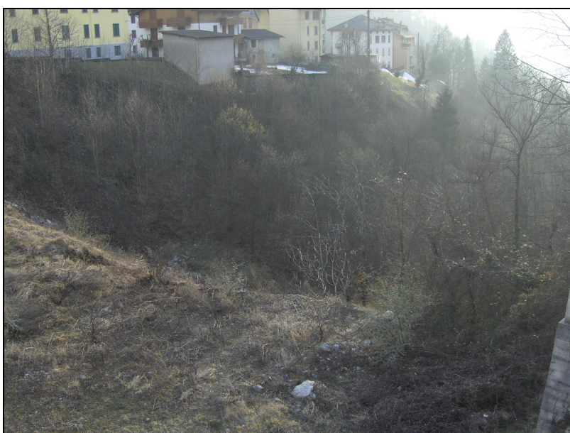
FOTO 17: punto nel quale termina l'interramento del canale, a valle del fabbricato che ospita il centro servizi comunale
