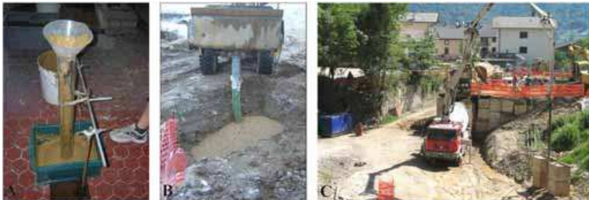
Fig. 5: a) prove di iniettabilità in laboratorio b) test in scala in cantiere c) impianto definitivo di iniezione.
